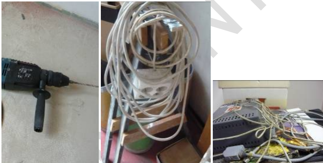
30. ábra. Javíthatatlan, leselejtezett elektromos kisépek, elosztók, kábelek
